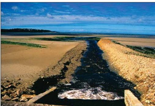
Armement des levées de berge du yar par la construction de bourrelets constitués du produit de curetage de fond de lit. La même opération a été menée sur les rives du Roscoat afin de contenir les deux cours d'eau dans un tracé rectiligne.
