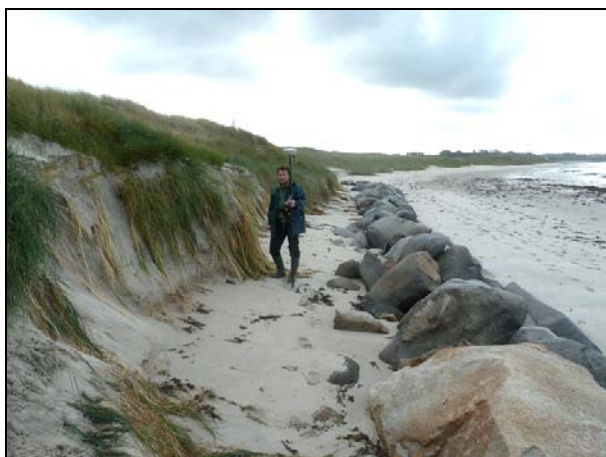
Photo 1. Falaise d'érosion et recul de la dune à l'arrière de l'enrochement de la plage du Curnic (Vougot) – 18/10/2012
