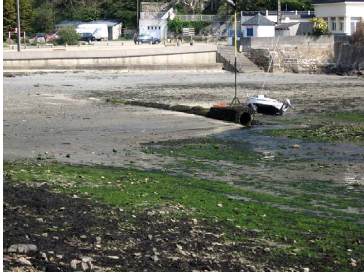
Figure 12 : Mai 2007, avant allongement de la buse, le sable du haut de plage est entraîné vers le bas de la zone intertidale par les eaux du ruisseau.
