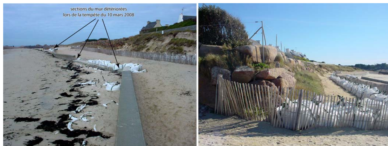
Photo 1 – Deux sections de mur qui ont été détériorées lors de la tempête du 10 mars 2008. Les bigbags ont été posés en avant du mur pour le maintenir alors qu'il avait été mis en porte-à-faux par l'érosion des sables du haut de plage. Dans le même temps, des bigbags et des ganivelles ont été posés un peu plus haut en pied de dune pour le protéger (clichés Suanez et Fichaut, 25/02/2009 et 30/03/2009).
